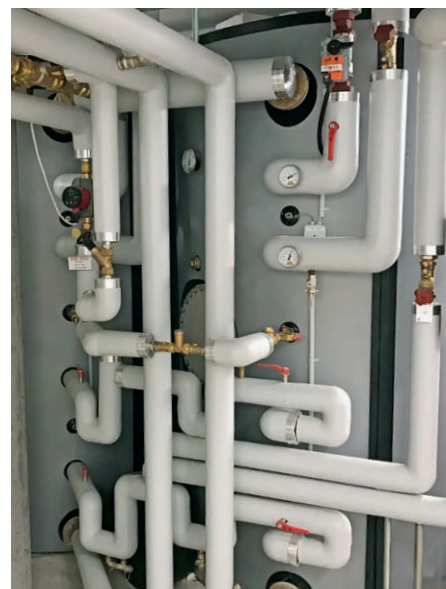
Detailansicht der Schnitzelheizung
