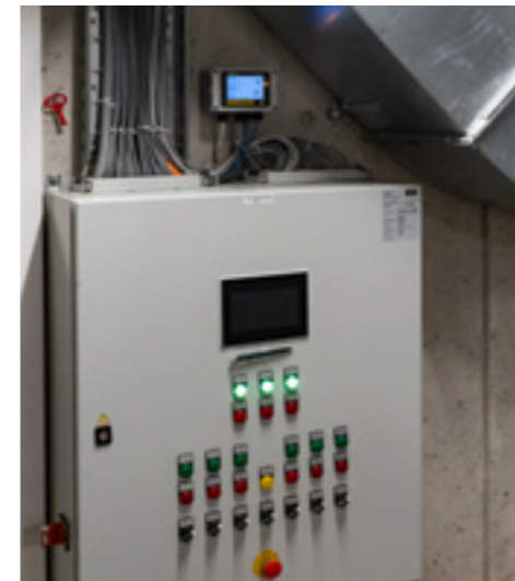
Schaltschrank für die Steuerung der Brennstoffaustragung
