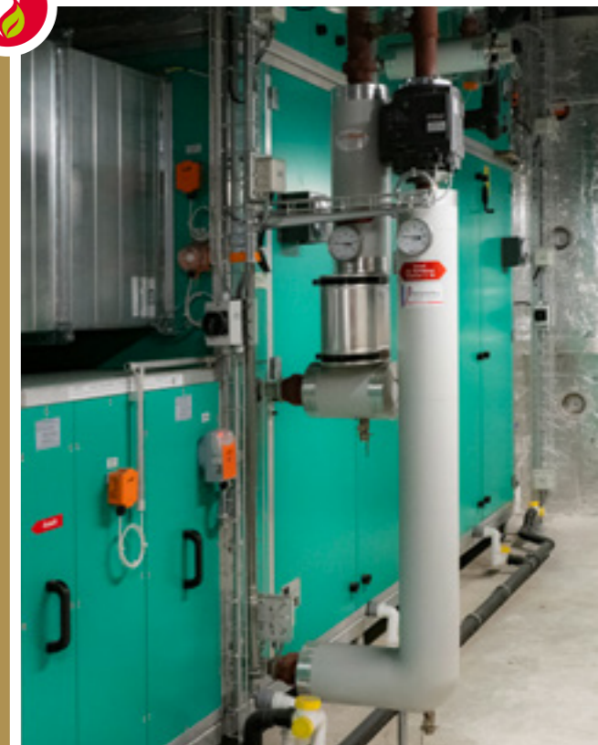
Die nach Planungsvorgaben programmierten Lüftungssteuerungen sorgen mit den gelieferten Regelkomponenten für das geforderte Raumklima im Hotel, den Restaurants und der Küchen.
